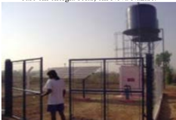
Figura 2 - Reservatórios de água em funcionamento com base em energia solar, em Nova Nazaré.
