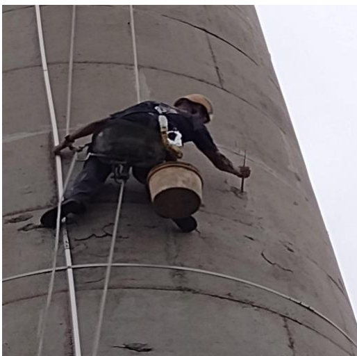
Figura 6 - Deslocamento de partes soltas
