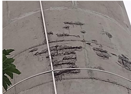
Figura 3 - Oxidação e deslocamento da caixa d'água de concreto
