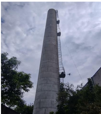
Figura 2 - Reservatório tipo torre
