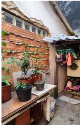
Figura 1 – Lavanderia sem reboco.
