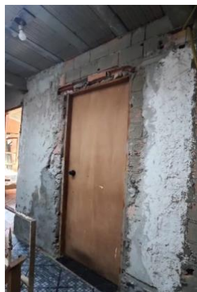
Figura 3 – Parede inacabada, porta sem verniz.
