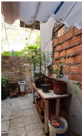
Figura 2 – Tijolos cerâmicos com patologia (mofo).
