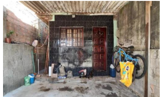
Figura 4 – Sobra de materiais, contrapiso sem impermeabilização.
