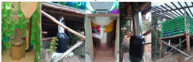
Figura 21 – Fotos do banheiro seco construído e o sistema sanitário seco pronto para uso.
